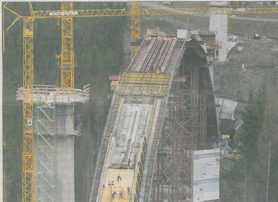
Die Arbeiter auf der Baustelle für die neue Massetalbrücke sind kaum zu erkennen.
