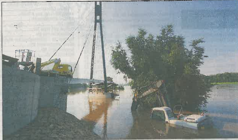
An der Baustelle der Molenbrücke ist ein Bagger abgesoffen.
