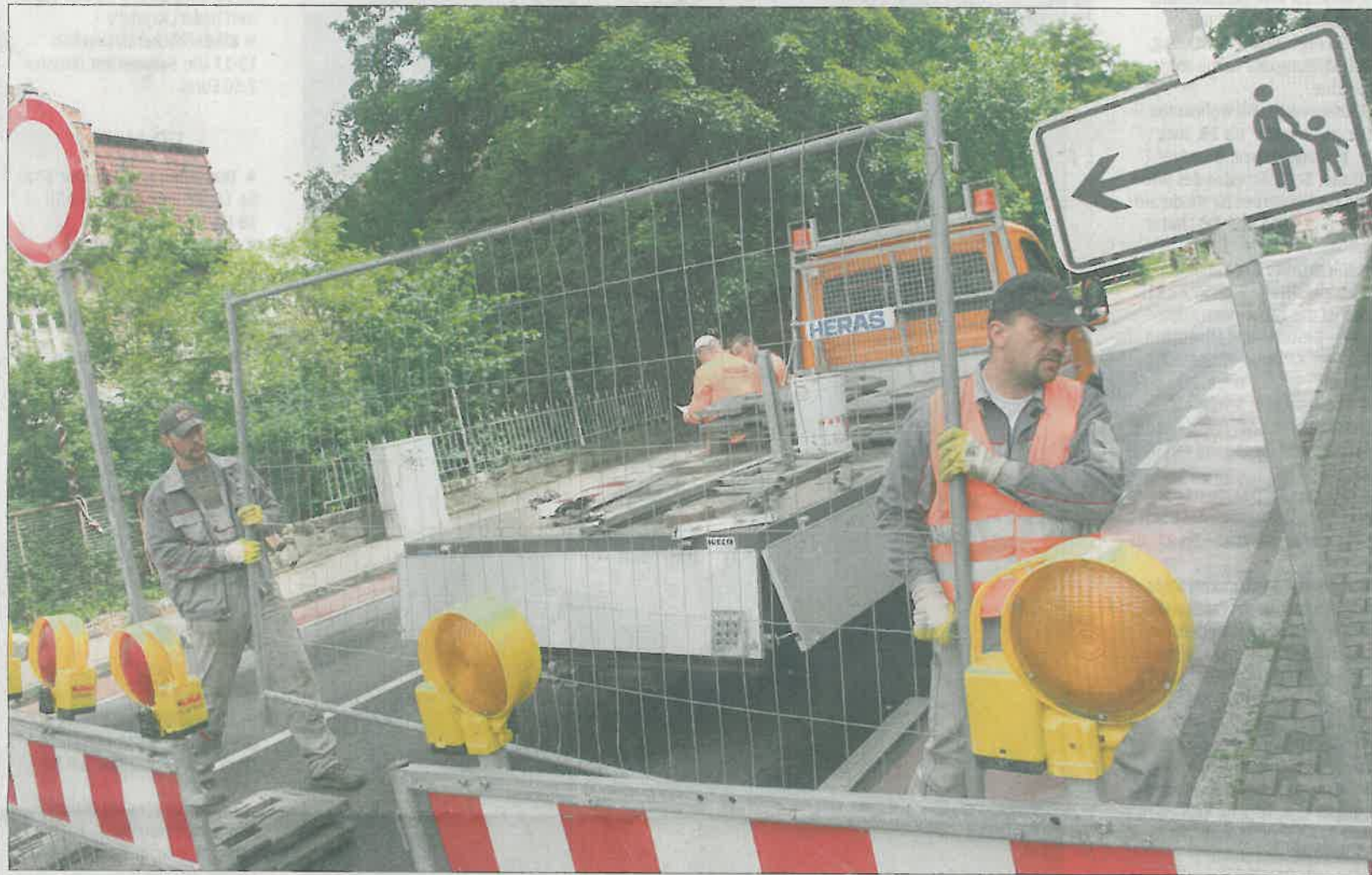
Jörg Schnelle (l.) und Jens Rimek von der Baufirma Hentschke aus Bautzen sperren die ehemalige Bundesstraße mit Bauzäunen ab – damit ist die Straße seit gestern Mittag dicht. Nur Fußgänger und Radfahrer können den Bahnübergang jetzt noch passieren. Foto: K.-D. Brühl
