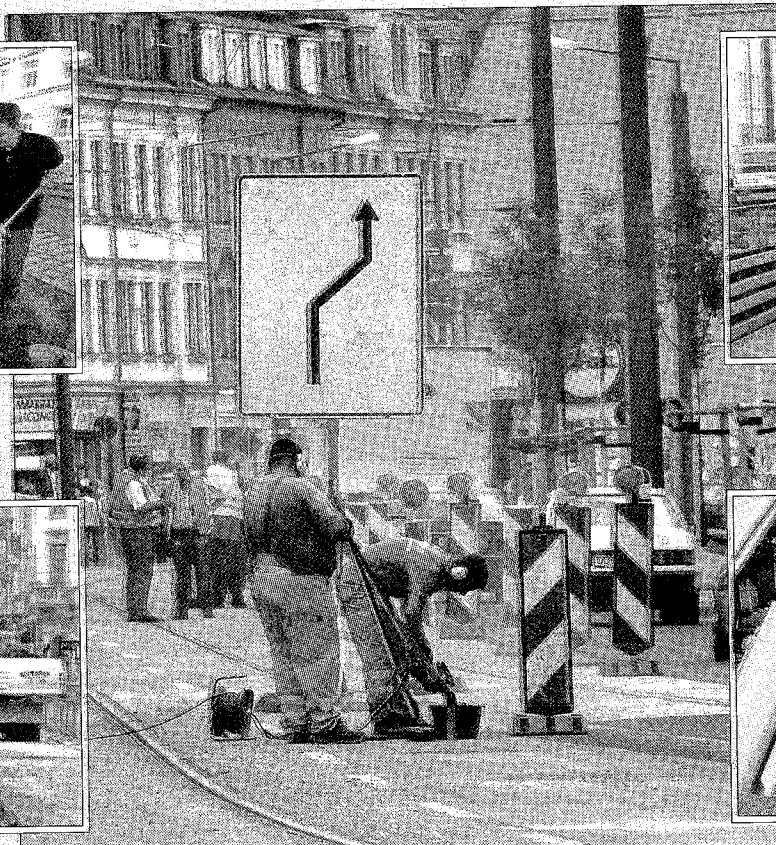
In weiten Teilen wie hier an der Oschatzer Straße ist die sanierte Straße schon komplett fertig.
