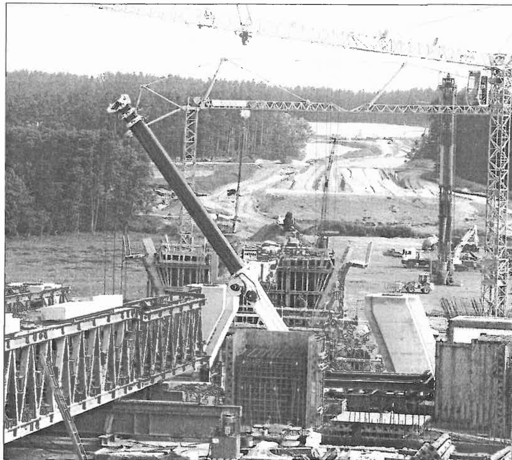
Gerade wird ein spezielles Gerüst (links im Bild) montiert, mit dessen Hilfe später der Überbau für die Autobahnbrücke Stück für Stück betoniert wird. Insgesamt soll sich das Bauwerk, das aus zwei parallelen Brücken für jede Fahrbahn besteht, 500 Meter über das Mühlental spannen. Fotos: Michael Beitien
