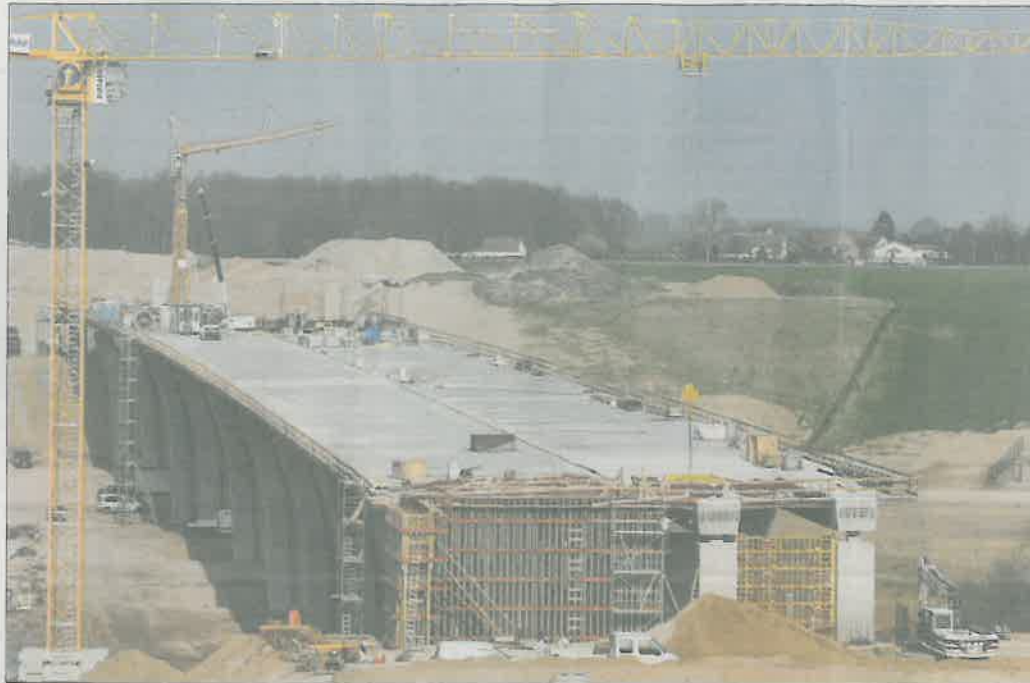
Autobahnbaustelle bei Liessow: Das Endmoränenland wird mit einer 340 Meter langen Brücke überspannt. Foto: Hans-Dieter Hentschel
