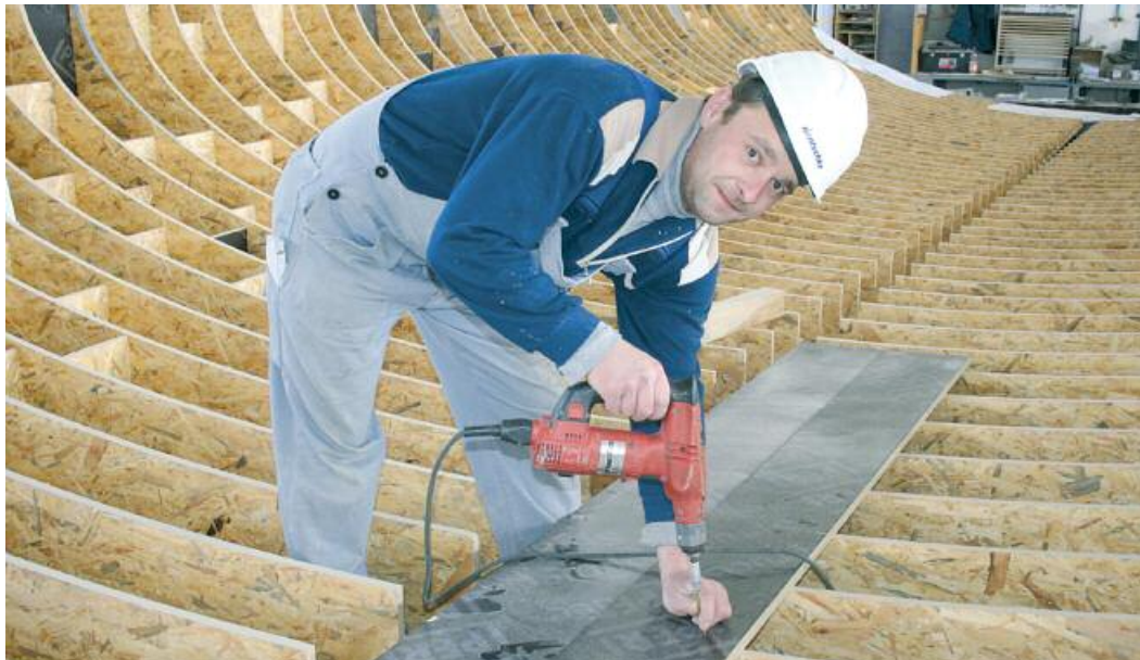
Eine große Herausforderung für die Hentschke Bau GmbH ist zurzeit die Errichtung einer 500 Meter langen Autobahnbrücke der BAB A 14 bei Schwerin, die das Mühlenbachtal überspannen wird. Das Foto zeigt Zimmerer Torsten Hänel. Er arbeitet an der Schalung für einen Brückenpfeiler.
